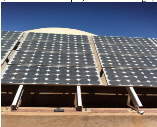
Fig. (3) PV (Siemens Showa Solar) modules.
